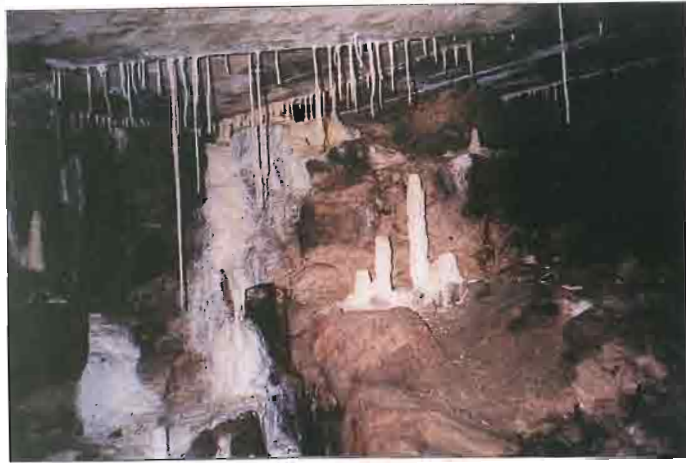
29 Stalaktiti i stalagmiti nastali izluživanjem vapna iz armirano-betonske ploče nad arheološkim lokalitetom Bunićeva poljana u Dubrovniku.
