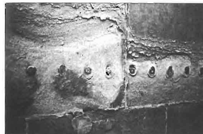
34 Štetne posljedice djelovanja vodenoga stakla na zid nastale nakon izvedbe horizontalne kemijske hidroizolacije (iz: Wih r, 1986)
