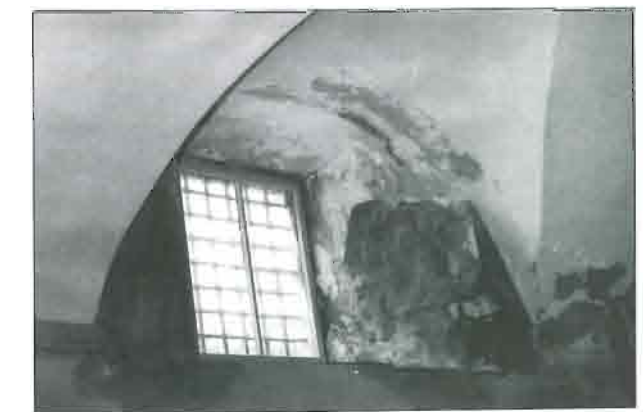
69 Unatoč izvedenoj vertikalnoj hidroizolaciji s bitumenom vlaga se pojavila zbog uporabe neispranoga morskog pijeska u žbuci (palača Sponza u Dubrovniku).
