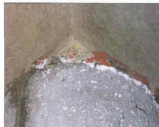
5 a) Vlagom i solima nagriženi stup od opeke u Velikome Kaptolu u Sisku staričari su nastojali sanirati izvedbom armirano-betonske obloge. Budući da vlaga i soli nisu bile odstranjene, željezna je armatura zahrđala pa je njezina ekspanzija razbila betonsku oblogu. b) Detalj vrha stupa s kristaliziranim starim solima iz opeke i novima dospjelim iz obloge od portland-cementa
