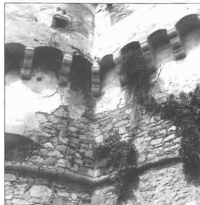
12 Na vlagom oštećenome zidu izrasle su raznovrsne biljke, koje svojim korijenjem uzrokuju sekundarna oštećenja građevinskoga materijala
