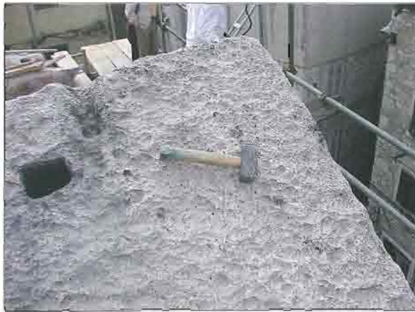
20 Dugotrajno korozivno i erozivno djelovanje kiše stvorilo je do 3 cm duboke škrape na kamenim blokovima na krovu Jupiterova hrama u Splitu.
