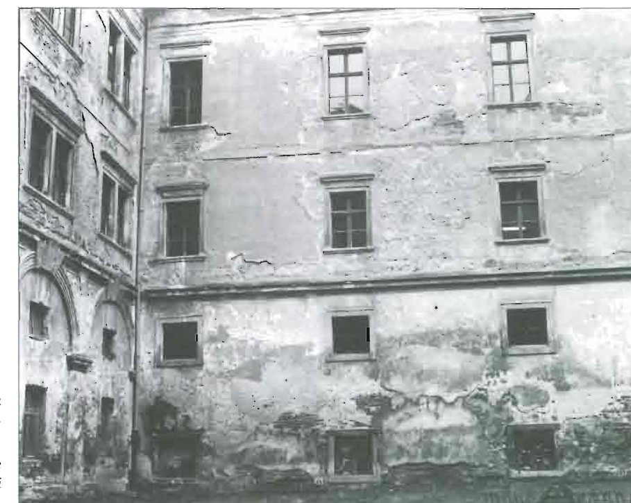
10 Kapilarna je vlaga dosegla do polovice prvoga kata u Novome dvoru u Čakovcu Capillary moisture coming to the middle of the first floor in Novi Dvor, Čakovec.
