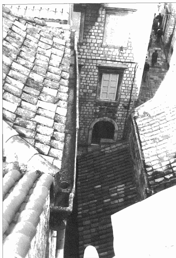
16 Spojevi na krovnim kamenim žljebovima često su loše zabrtvljeni, pa kiša prodire u zidove (palača Sponza u Dubrovniku).
