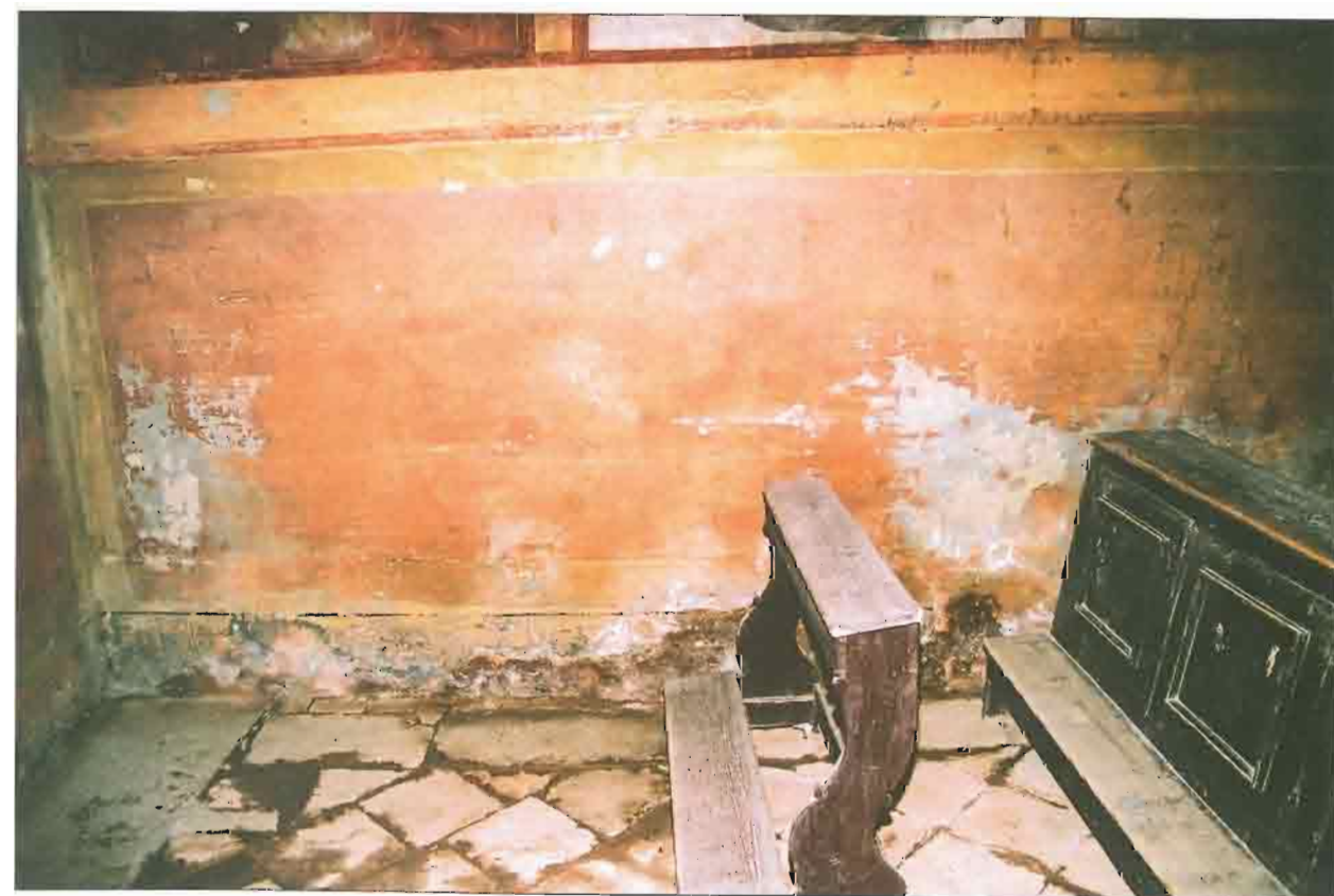
Višnjan, crkva sv. Antuna, kondenzna vlaga na podu (foto Goran Bekina)
